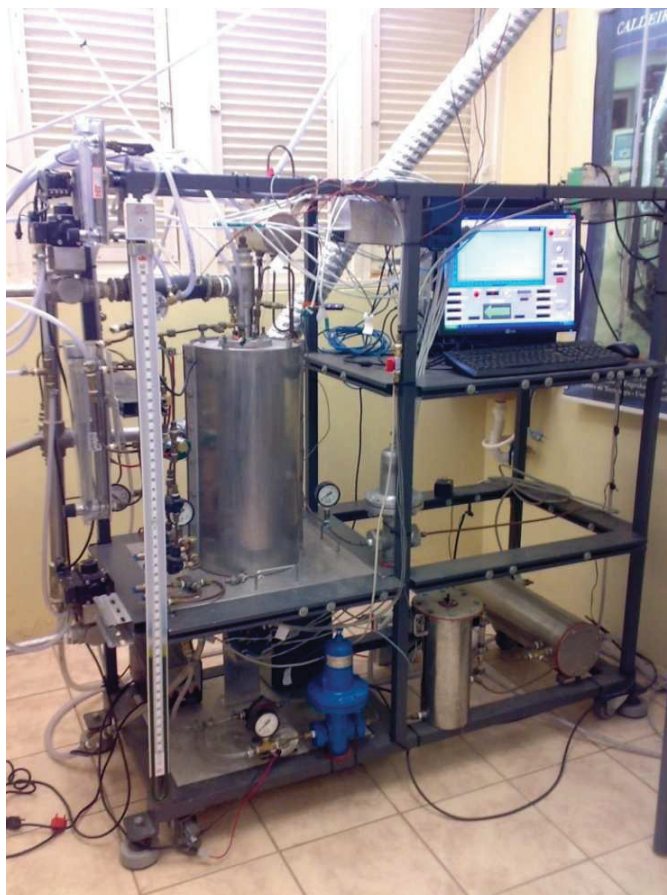
Figura 3.4 - Foto da Caldeira Superadiabática instalada no LACER.
