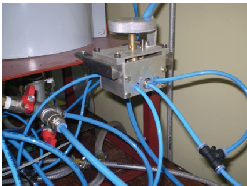
Figura 0.9 - Detalhe da Válvula de Controle do Processo
